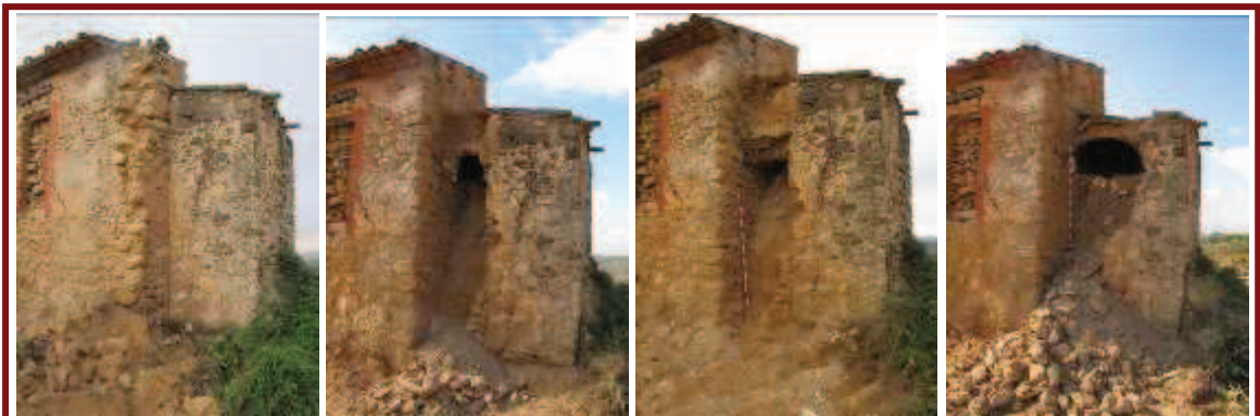
Seqüència gràfica corresponent al procediment d'actuació del procés d'enderroc, retirada de runes i documentació i registre de les estructures i elements afectats.
