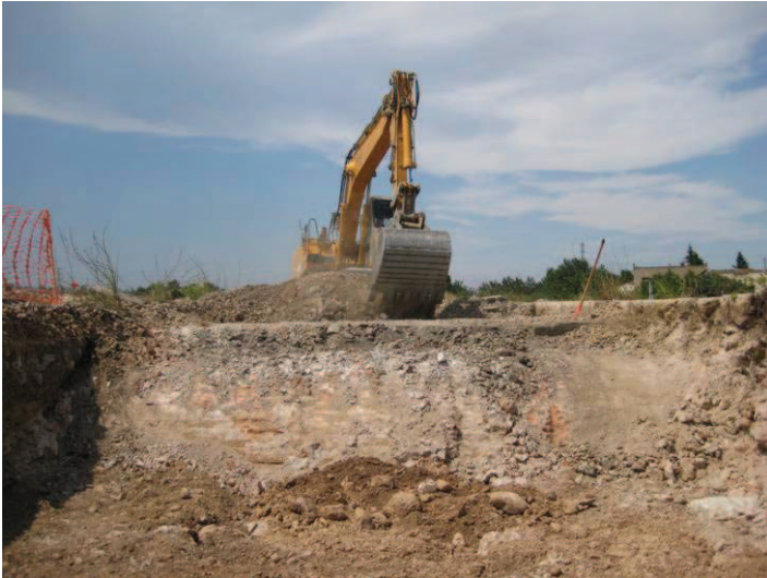
Treballs de retirada dels nivells de terraplenament interior de la caixa del pont que s'ha portat a terme amb mitjans mecànics.
