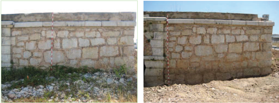
Seqüència gràfica del mur de contenció de l'estrep sud-oest del pont del ferrocarril on es pot apreciar tot el conjunt del parament exterior del mur, una vegada es van retirar els nivells de terraplenament que ocultaven la part inferior del seu aparell constructiu.
