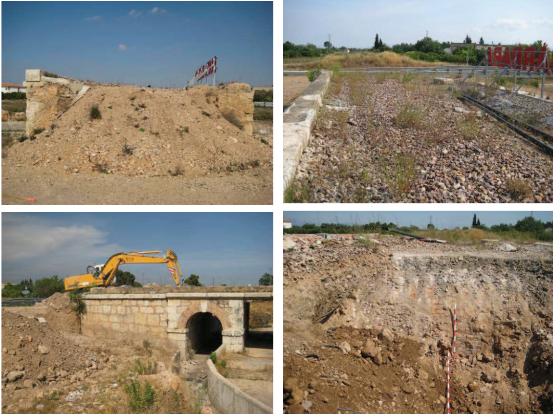
Les imatges il·lustren l'estat que presentava la plataforma ferroviària del pont del ferrocarril abans de la present intervenció, amb la capa de balast sense les vies (imatges superiors) i les actuacions que s'han portat a terme amb la finalitat de documentar el procés constructiu dels nivells de rebliment.
