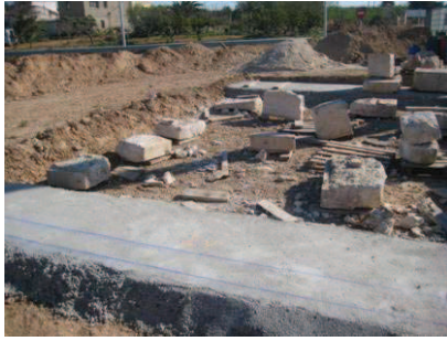
Preparació del terreny amb la solera de formigó i el replanteig de les parts.
