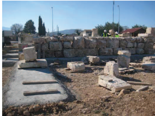
Presentació dels elements petris de l'estructura del pont, actuació prèvia al relligament amb formigó del conjunt de les estructures.
