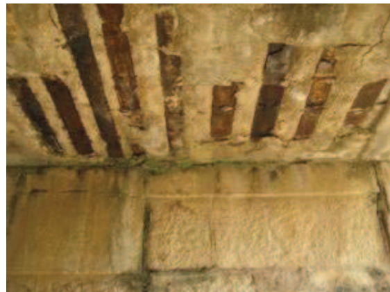
Detall de l'estat que presentava la part inferior de la plataforma dintellada que cobria la galeria de l'espai central del pont, on es pot apreciar la seva fàbrica constructiva.
