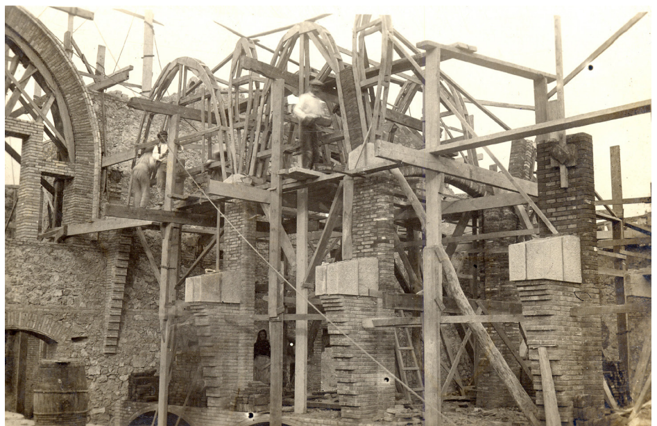
Procés de construcció del celler del Pinell. fons César Martinell. Museu de Valls.
