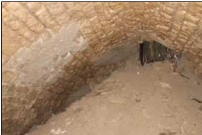
Estat de l'Interior de la cisterna abans de dur a terme cap actuació
