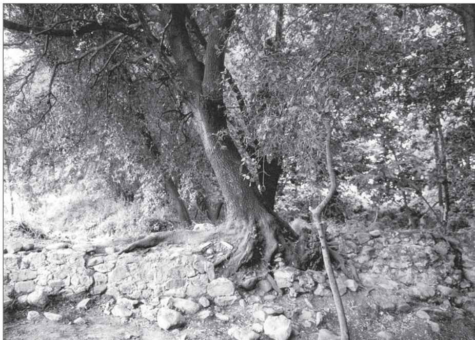
Aqüeducte de Malhivern. Detall d'una alzina que està destruïnt l'estructura de canalització de l'aigua
