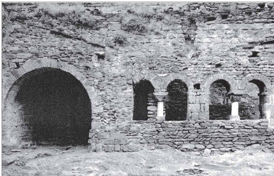
Foto 4. Vista del podi de la galeria nord des de l'interior del claustre. Clixé Pep Callís.
