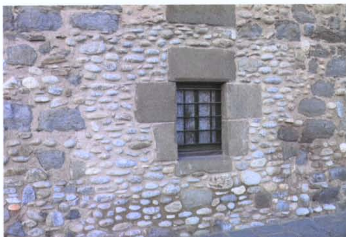
DETALL D'UNA FINESTRA A LA PLANTA BAIXA. EN EL PARAMENT S'APRECIA UNA REFORMA PROBABLEMENT PRACTICADA EN OBRIR-LA.
